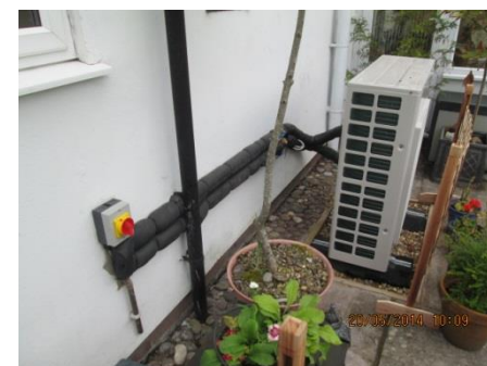
Bombas de Calor
